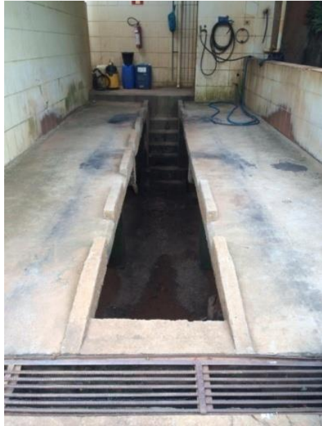
Figura 9 – Vala de troca de óleo de veículos de grande porte
